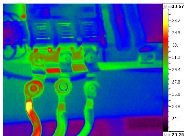
Рисунок 21. Пример термограммы контактных соединений с температурной шкалой
