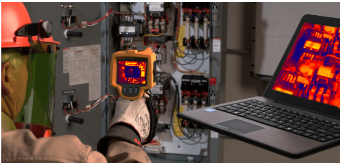
Рисунок 20. Пример проведения тепловизионного контроля электрошкафа
