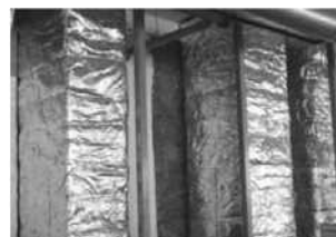
Воздуховоды с покрытием СПЛЕНД
